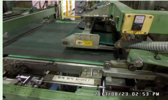
자동 포장기에 설치된 벨트컨베이어
